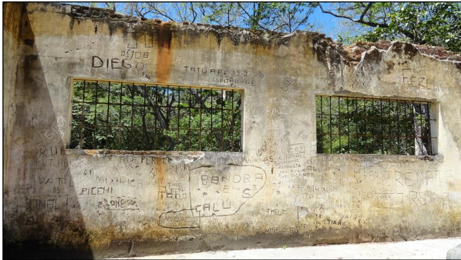
Figura IV.2- 8 – Sinais de vandalismo praticado por visitantes.
