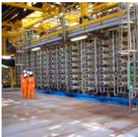
Unidade dessalinizadoras (UD) Dessalinização da água do mar
