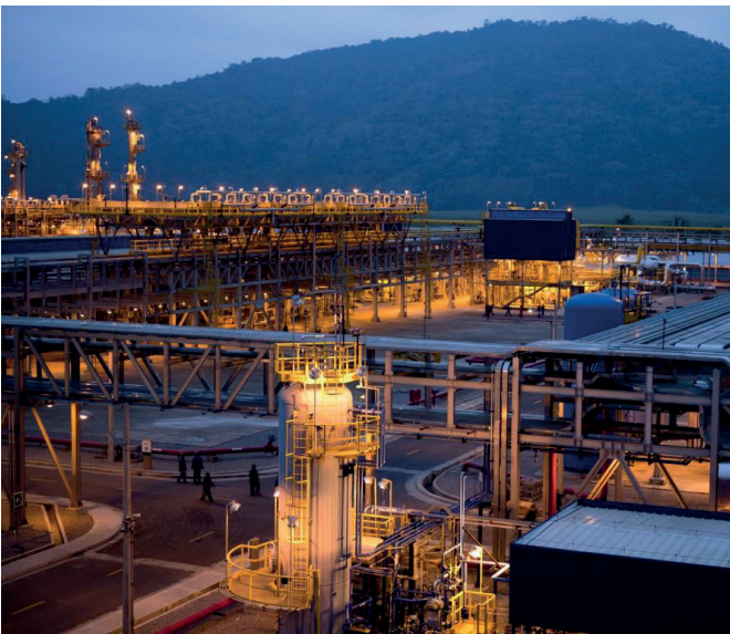
Imagem 15: Unidade de Tratamento de Gás de Caraguatatuba (UTGCA)
